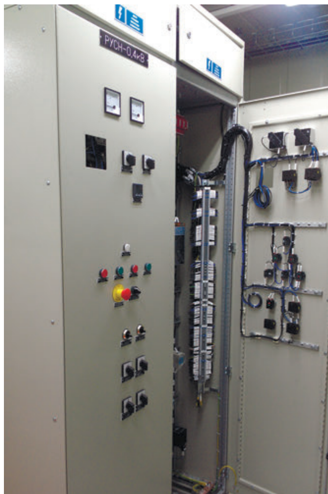
Шкаф РУСН в модуле СКП
