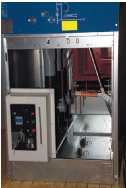
Отсек с силовым выключателем и ТТ
