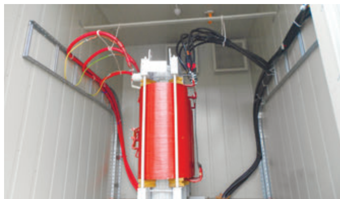
Понижающий трансформатор ТС 400кВА 10/0,4кВ
